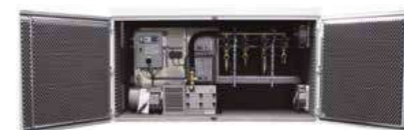
Exemple d'armoire de pilotage
